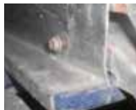
Rostig skruv och oxiderad krok
